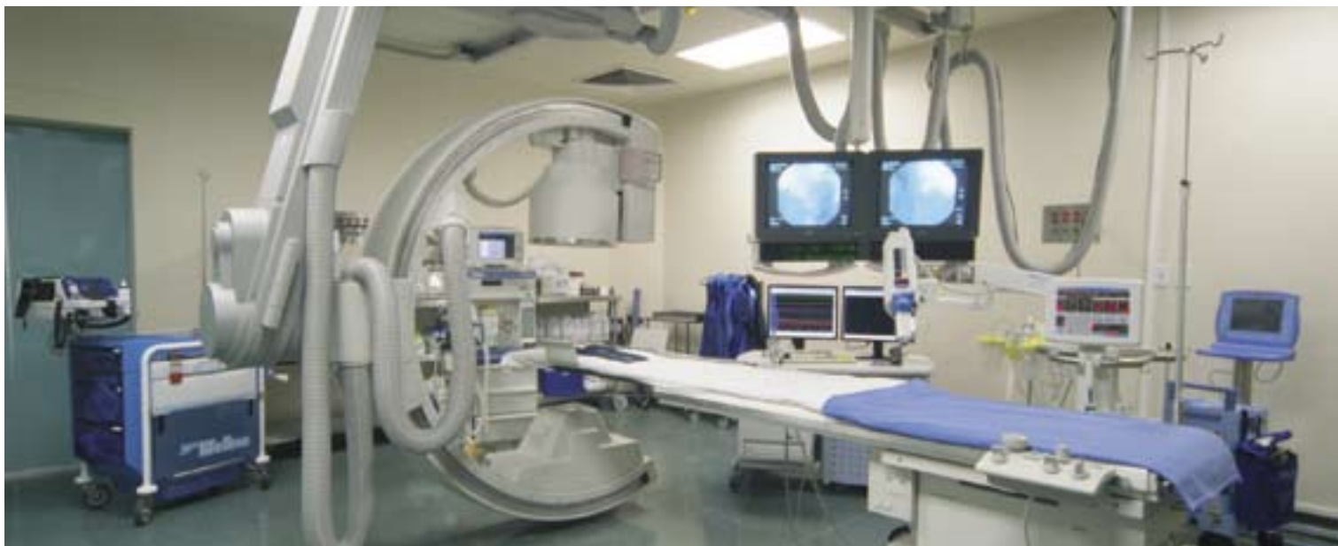
Instalaciones de la sala de hemodinamia HOSPITEN Cancun
